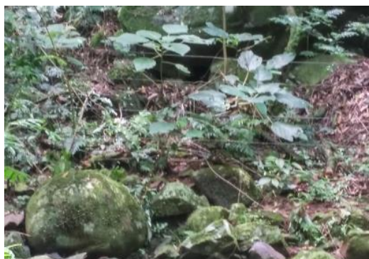
Figura 7. Crescimento de vegetação entre os pedregulhos, em 2016.
